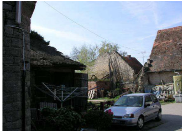
Abbildung 58: Blick auf ruinöse Reste, Baulücke Fl. Nr. 201
