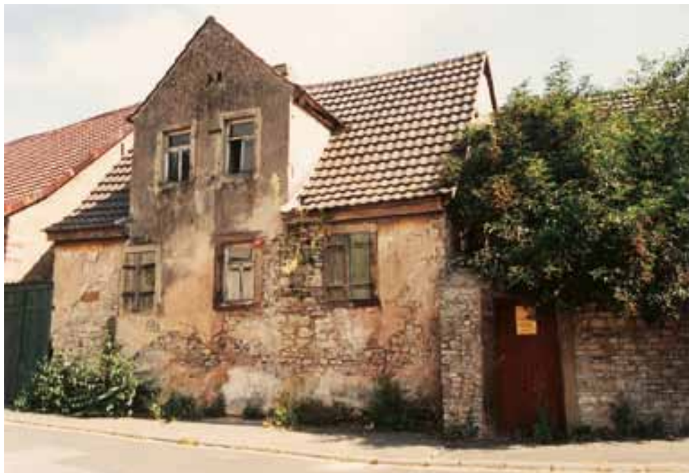
Eingeschossiger Bau mit mittig angeordnetem Zwerchhaus, keine weiteren Dachaufbauten vorhanden; Gebäude leider stark sanierungsbedürftig.
